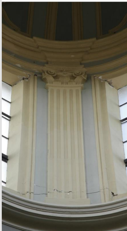
Particolare delle lesioni interne
